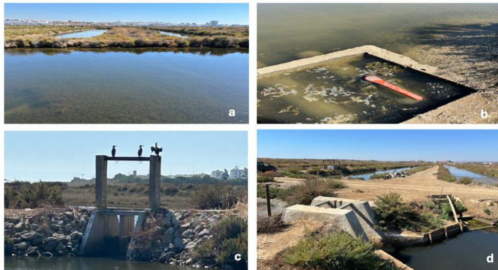
Figura 3. Sistema de tanques (a); válvula de retenção (b) e comportas (c, d).
